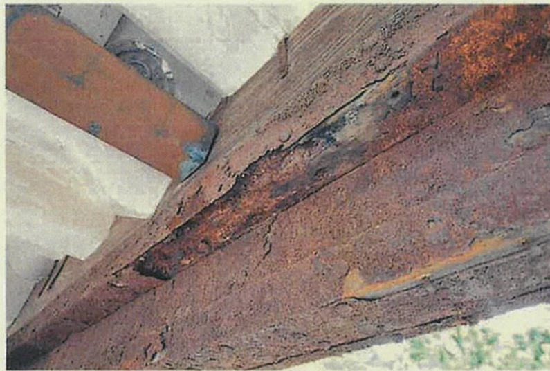
③冠木、大扉欄下端筋哲劣化状況
