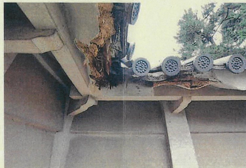
④表二の門西側土塀入隅谷周辺破損状況(東より)
