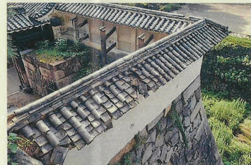
⑤表二の門西側土塀 堀側屋根破損状況(西北石垣上より)
