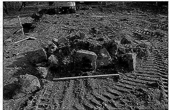
写真3 き損した石材状況／北から
