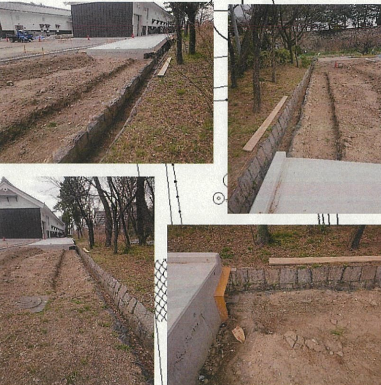
①現状変更許可申請に記載のない掘削を行っていたもの
