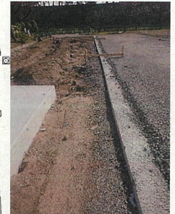
②学芸員の立会いなく、掘削と基礎施工が行われていたもの
