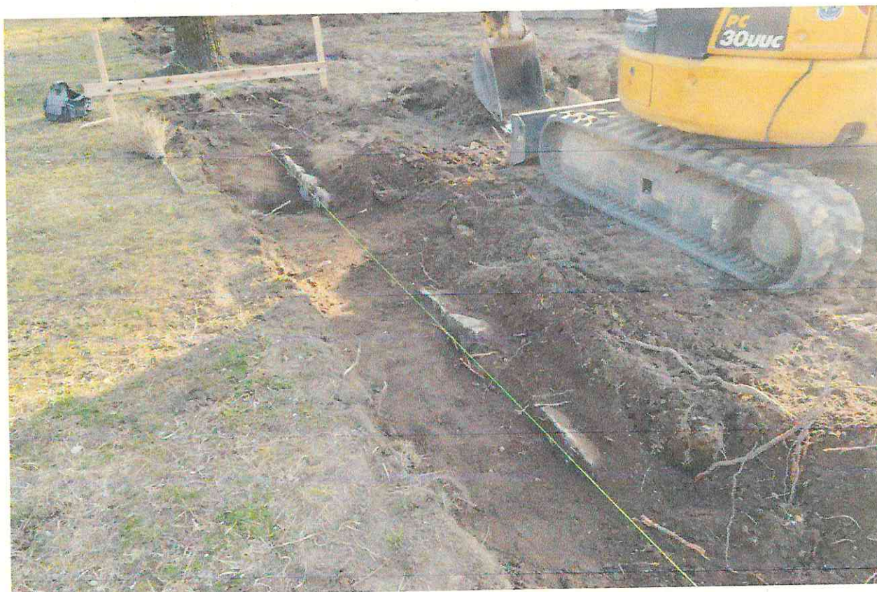
写真3 き損直後の石列残存状況／北東から
