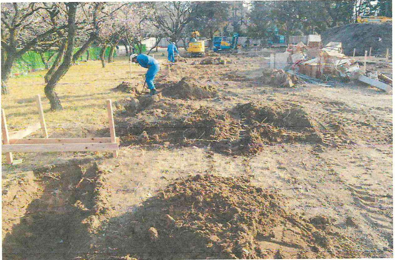
写真1 き損直後の現場状況／北から
