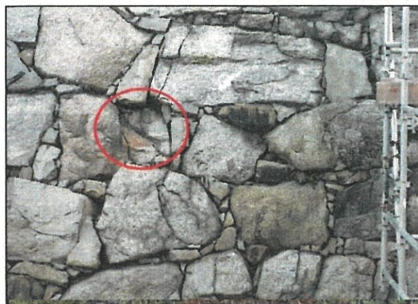
写真2 石材片落下後の状況
