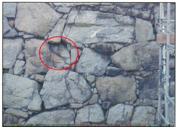
写真2 石材片落下後の状況
