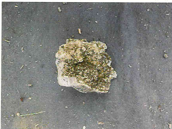
落下したモルタル片
