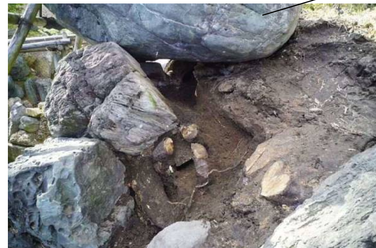
東側面の空隙状況
