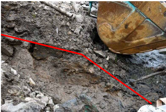
図7 001-5054 背面堆積状況（赤い線より上がへドロ状堆積、下が黄褐色粘質土）（南から）
