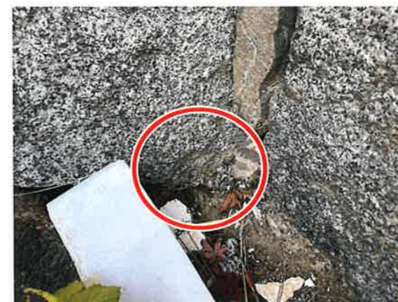
図7 東側石垣(019H) GL+2.5m 付近 雁木痕跡の可能性がある加工痕
