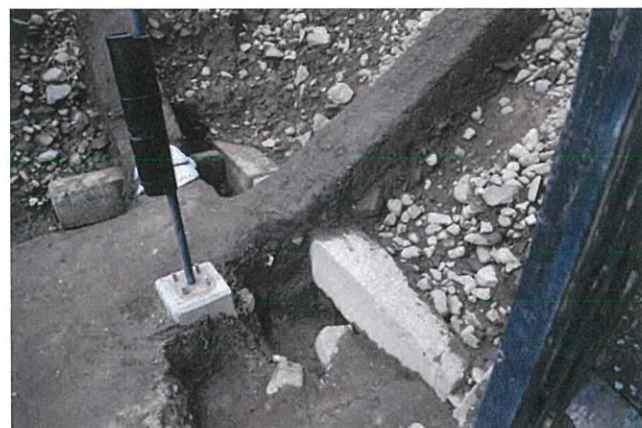
図 18 西側土塀 切石側面の変色
