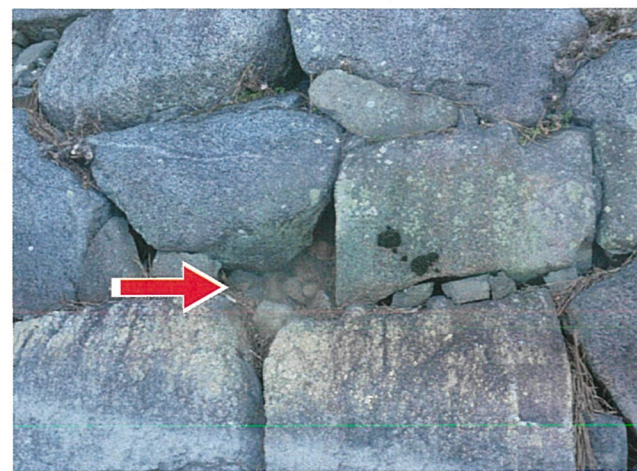
間詰石の抜け状況
