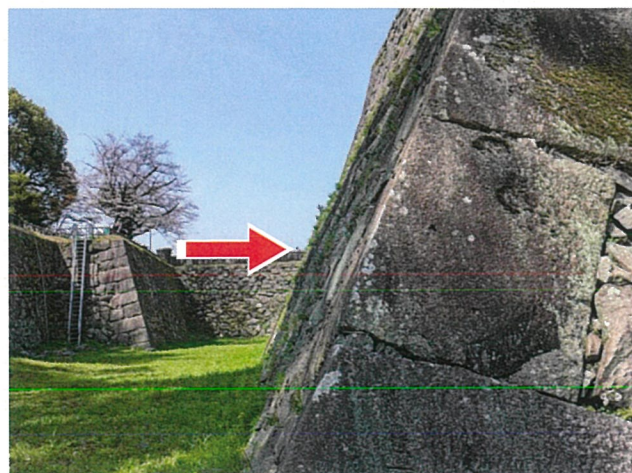
石垣面での膨らみ状況
