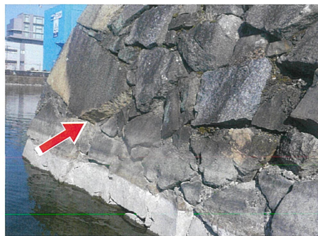
角石の割れ状況
