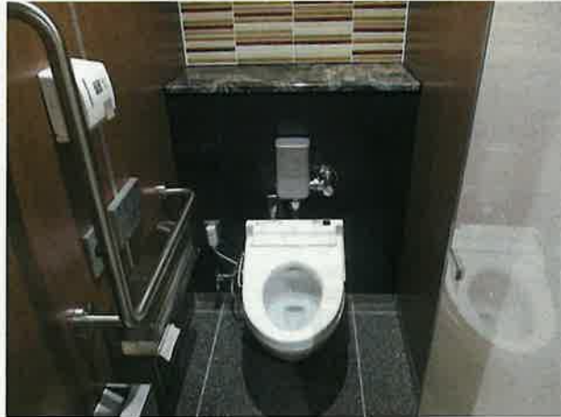
【一般トイレブース】
